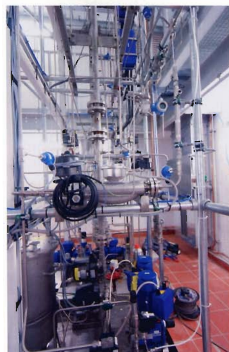
Abb. 3: ...sitzen im Aufreinigungsteil (downstream) und genügen den Anforderungen der ATEX für die Ex-Zone 2.
