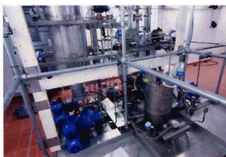
Abb. 2: Die 10 installierten Pumpen von Bran+Luebbe...
